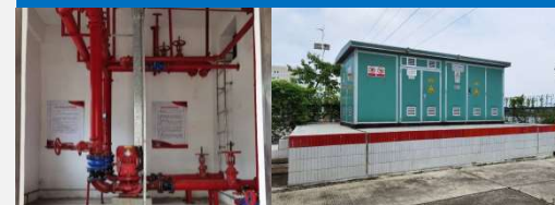
应急风控与高压电力配套设施
